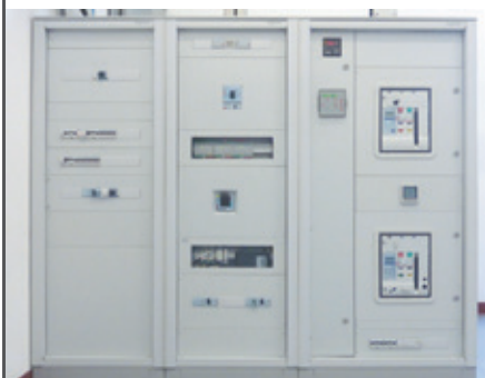
Щит шкафной на 4000 А с устройством ввода резервного питания на базе выключателей DMX 3
