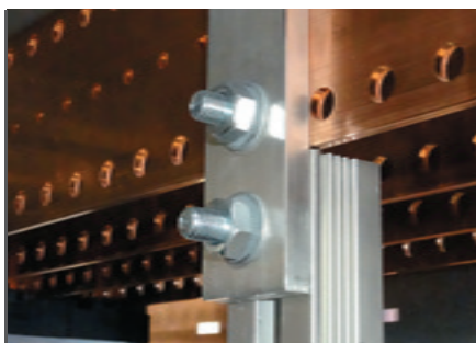
Соединение между алюминиевыми и главными шинами создается с помощью плоских шин с коннекторами Кат. № 0 373 82 (1 шина на фазу).
