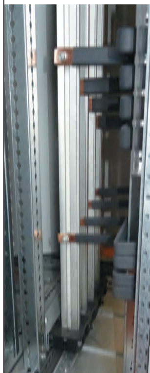
Шины, установленные в кабельной секции.
