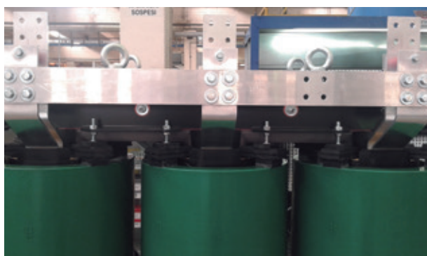
Пример выполнения выводов обмотки низкого напряжения
