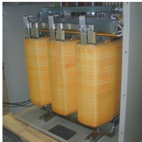
400 кВА с алюминиевыми обмотками
