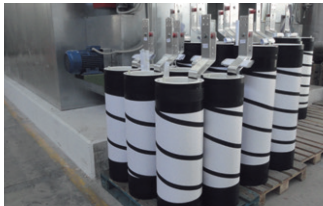
Обмотка низкого напряжения
