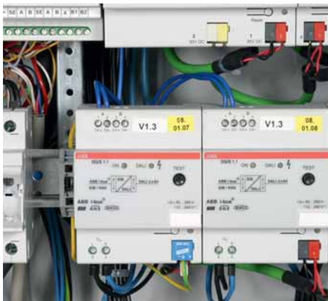
УЗИП с соединительными проводниками для шин EIB/KNX.
