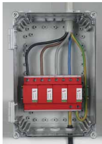
Пример установки: модульное УЗИП DEHN-ventil M TNC установлено в изолированный корпус IGA 10 V2 IP54.
