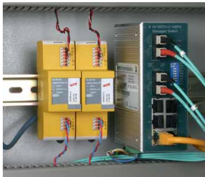
Защита выходов громкоговорителя системы аварийного оповещения.
