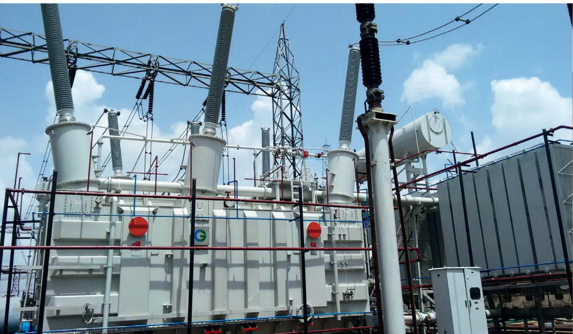
Вводы 252 и 420 кВ на трансформаторе индийской компании PowerGrid
