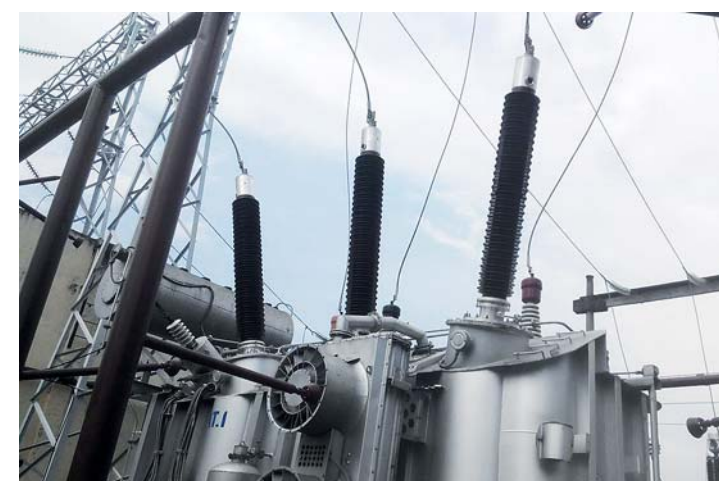
Вводы 252 кВ на трансформаторе ГЭС Хоабинь во Вьетнаме 252 kV bushings installed in transformer at Hoa Binh HPP in Vietnam
