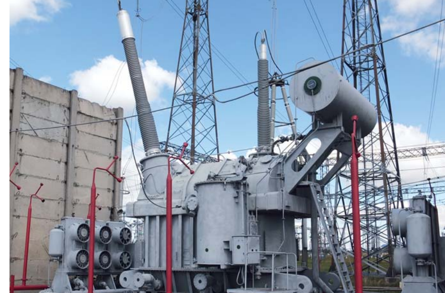
Вводы 800 и 550 кВ на авто-трансформаторе МЭС Северо-Запада 800 and 550 kV bushings in a autotransformer at IDGS of North West
