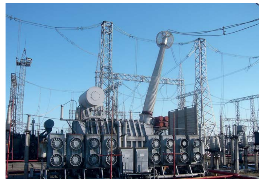
Вводы 1200 кВ на реакторе 300 МВА МЭС Сибири 1200 kV bushings in a 300 MVA reactor at IDGS of Siberia
