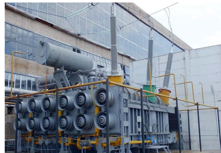
Вводы 550 кВ на трансформаторе Костромской ГРЭС 550 kV bushings in a transformer at Kostromskaya SDPP
