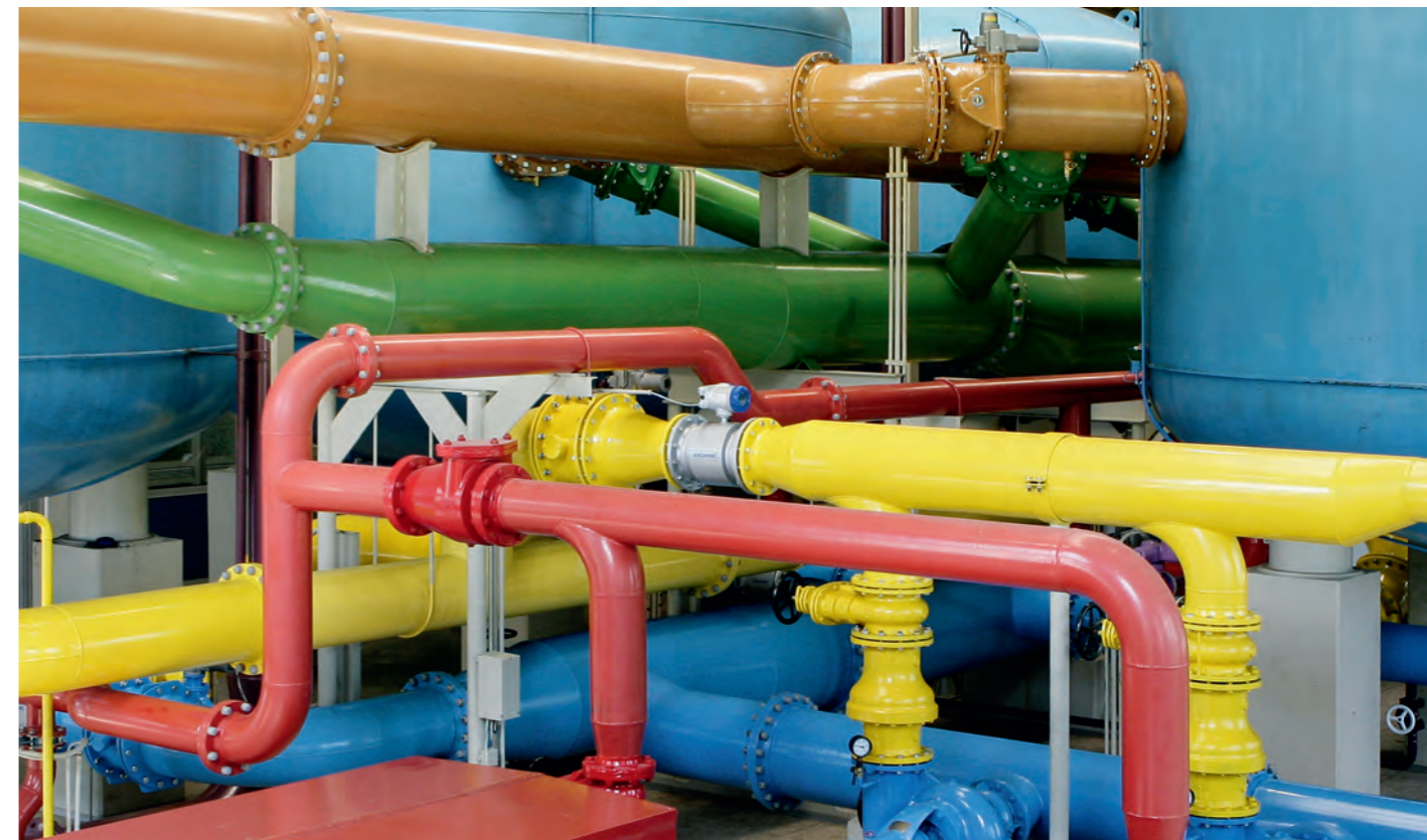
OPTIFLUX 4300 в системе фильтрации на гидротехнических сооружениях в Хальтерне, Германия
