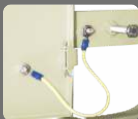
Все двери корпуса заземлены
