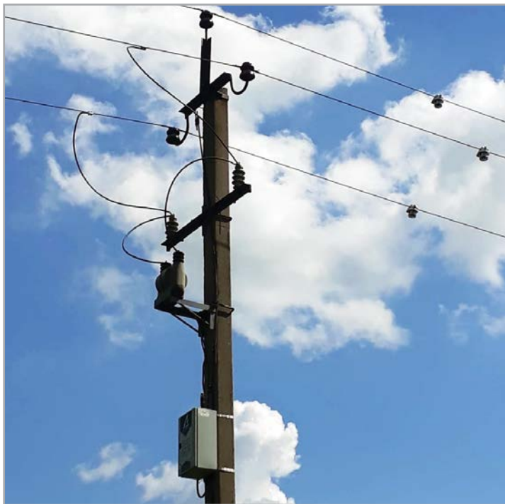
Установленные на проводах ВЛ индикаторы короткого замыкания с блоком передачи информации
