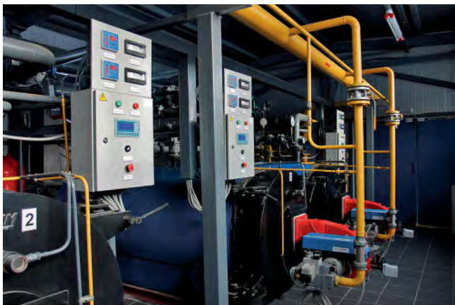
Автоматизированная котельная в Смоленске на базе оборудования ОВЕН (ЗАО «Центромонтажавтоматика»)
