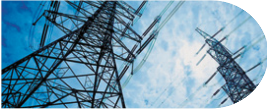
ПЕРЕДАЧА И РАСПРЕДЕЛЕНИЕ ЭЛЕКТРОЭНЕРГИИ
