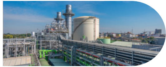
ПРОИЗВОДСТВО ЭЛЕКТРОЭНЕРГИИ И ОЧИСТКА ВОДЫ
