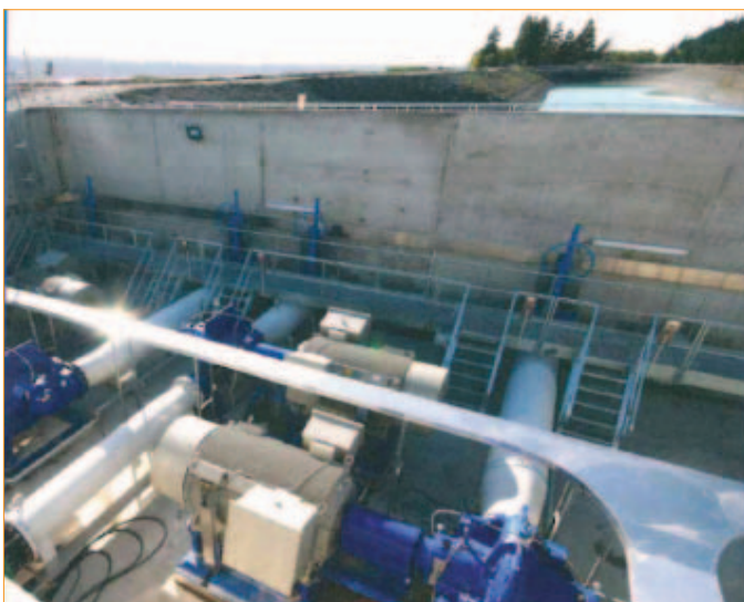
Actual Water Pump
