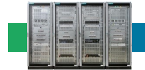
Шкафы АСУ ТП и АИСКУЭ
