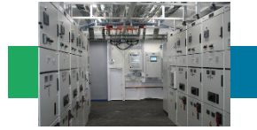
ЗРУ и КТП (6-35 кВ)
