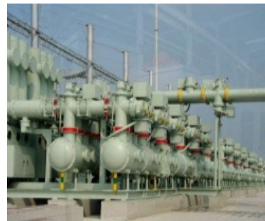
КРУЭ наружной установки (110-220 кВ)
