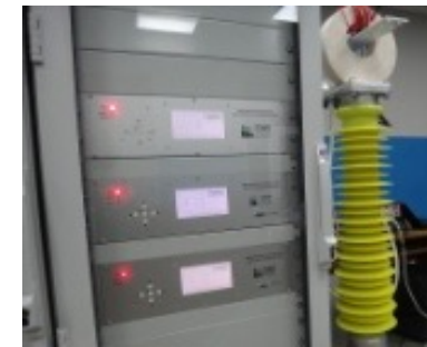
Решения по цифровизации коммутационного оборудования
