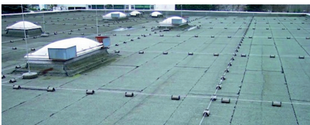
Молниеприемная сетка на плоской кровле
