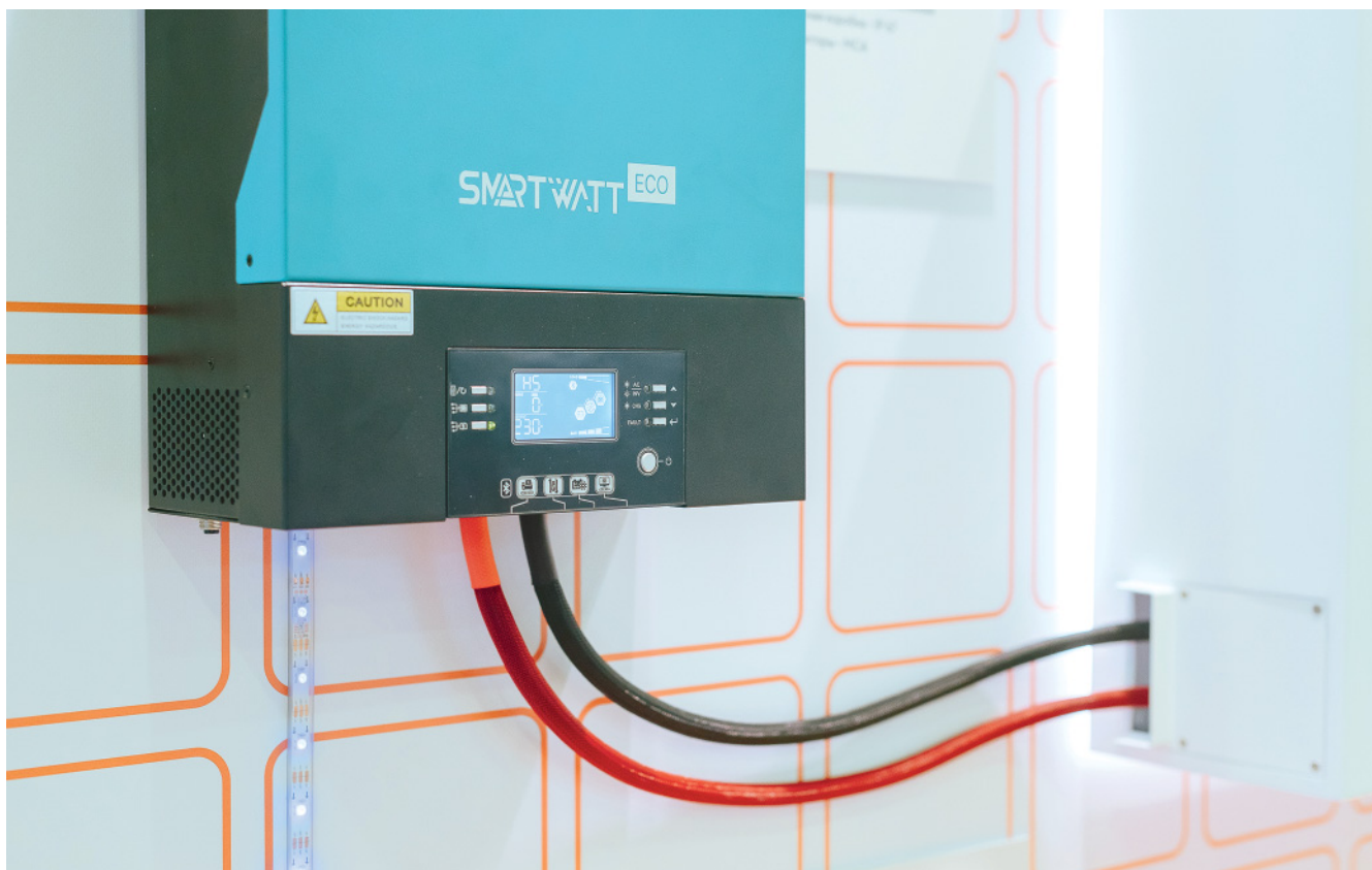
Инвертор SMARTWATT ECO мощностью 5 кВт, подключенный к литий-ионной батарее
