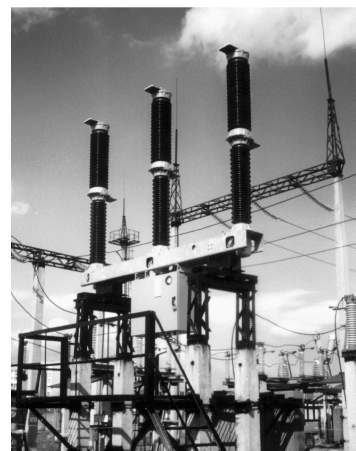
Подстанция Ново-Косино в Москве
