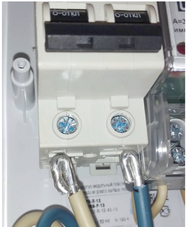
Вариант надежного подключения алюминиевой жилы через автоматический выключатель
